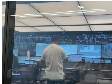
Imagem 11 - Centro de Monitoramento de entrada e saída e disponibilidade de Gás da TAG
